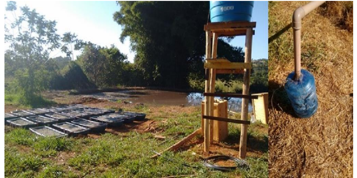
Sistema de captação de esgoto doméstico mostrando o reservatório, os sistemas alagados construídos e a proteção da válvula de pé com crivo.
